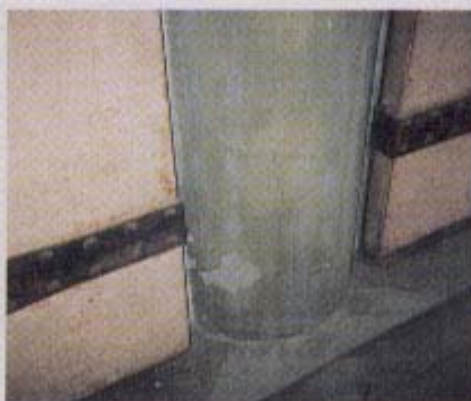
5月28日の地震では本堂正面の再塗装部分に亀裂と剥落が生じた。
