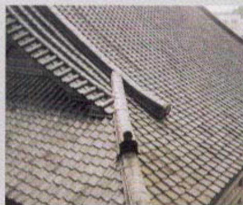
降り棟の破損
